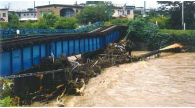
鰯ヶ沢町でJR五能線 橋脚が沈下
